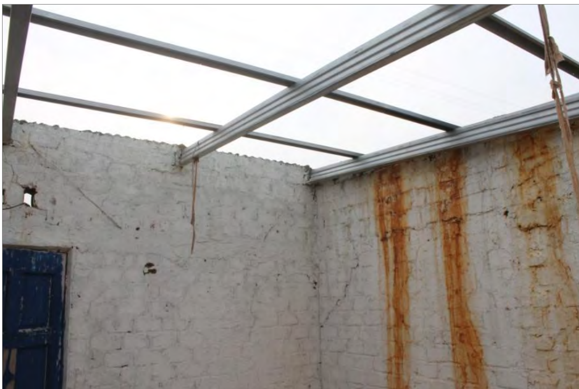
Maison detôlée à Kokiza - Thierry N'Zeng – CERN
