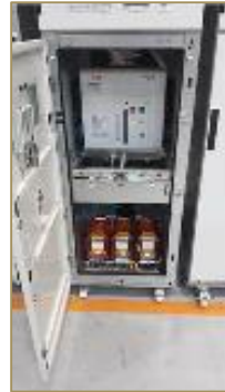
Breaker ABB 11kV/630A
